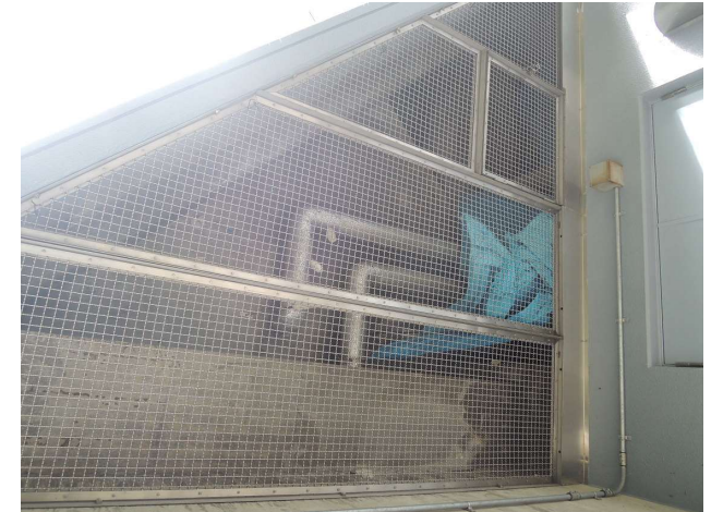
発電室前外 上部給気口
