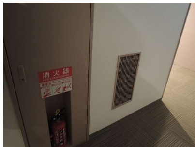
廊下給気口 (低温の外気がそのまま入ってくる)
