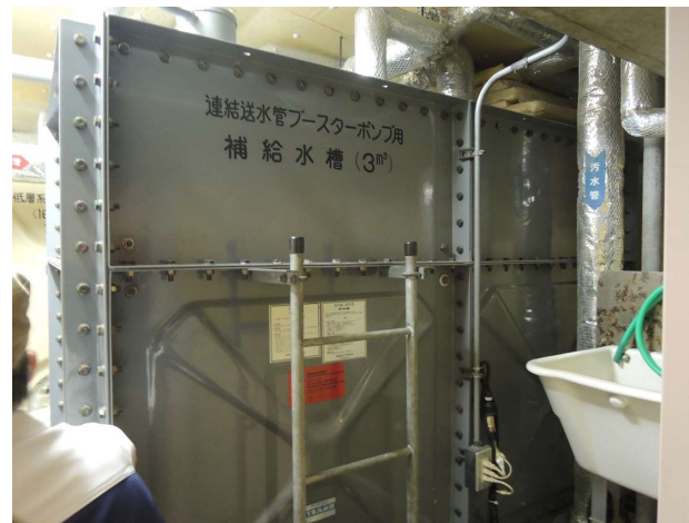
機械室内 補給水槽
